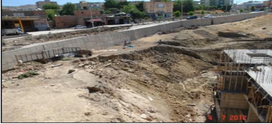
Şekil 2. Tarım Lojman Binası Kazı sonrası Heyelan
